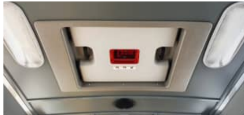
루프 비상 탈출 장치 (2개소 설치)
